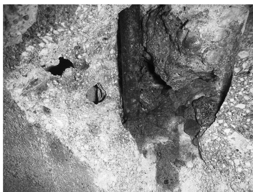
写真 6 ブロック孔側面に寄って配筋された鉄筋。コンクリートは中性化していない（濃灰色）が，ブロックと鉄筋の隙間に充填されていないため，腐食している。
