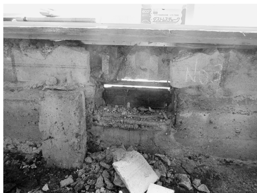
写真 5 換気口上部に露出する鉄筋 (S2)
