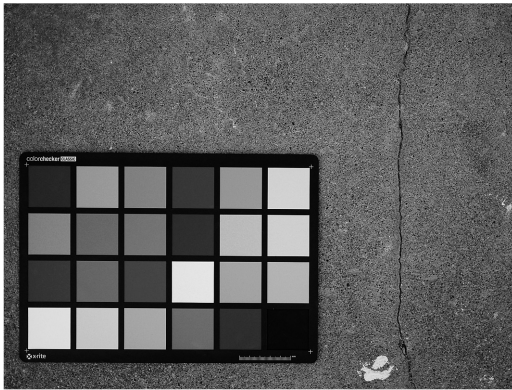
写真8 空き家壁面のひび割れ部分とカラーチャート
