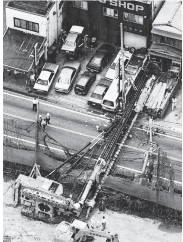
図1 東大阪市の杭打機転倒事故 5) (1997) (写真：共同通信)
