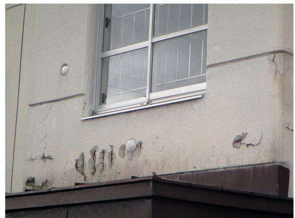
図5 階段室外壁の変状(建築物A)
