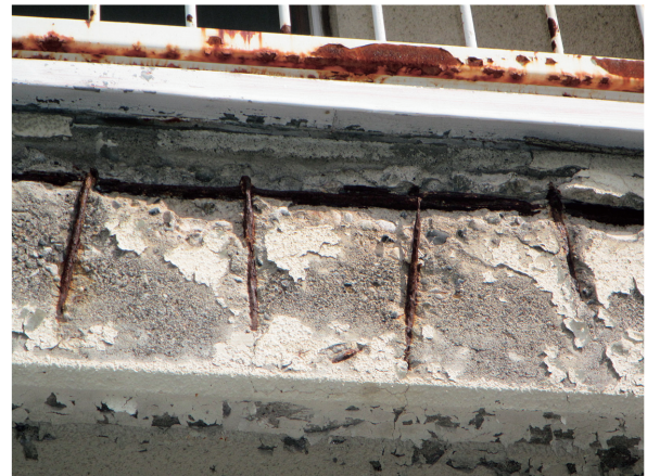
図4 バルコニー先端部の変状(建築物A) 7)
