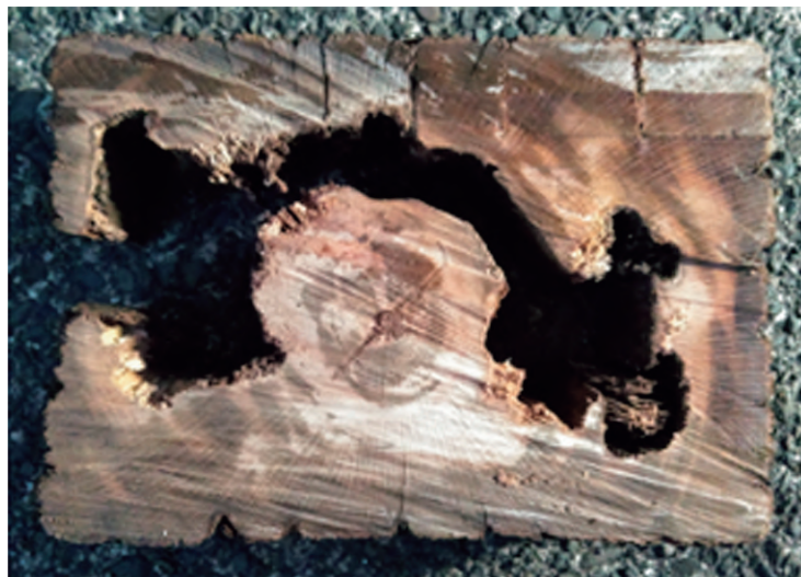
図15 木まくらぎ内の空洞（不良）
